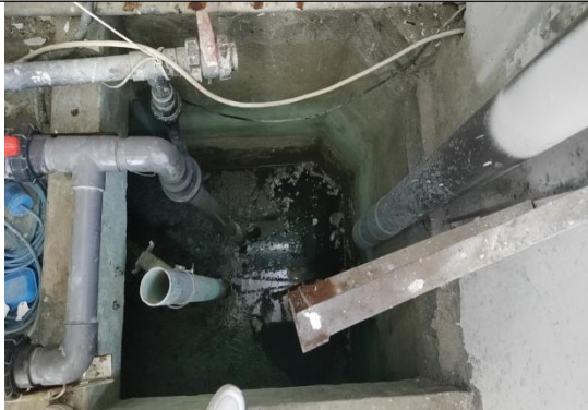
事故应急池照片
